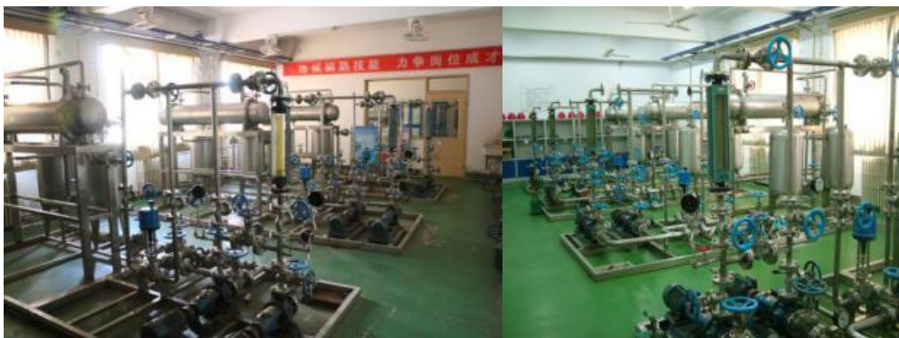
管路拆装实训室
