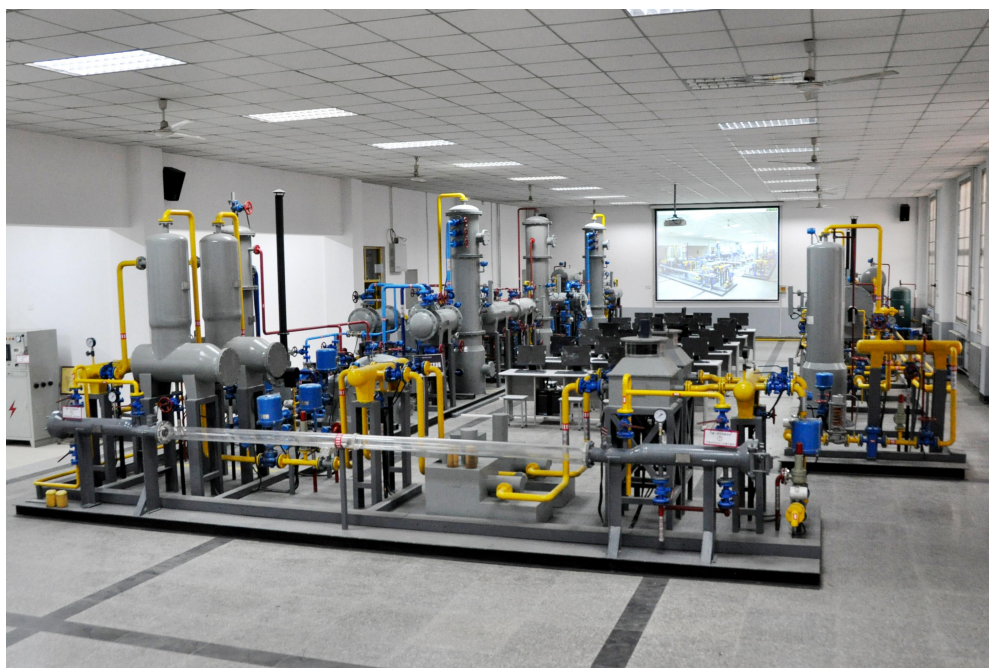
天然气采集输实训室
