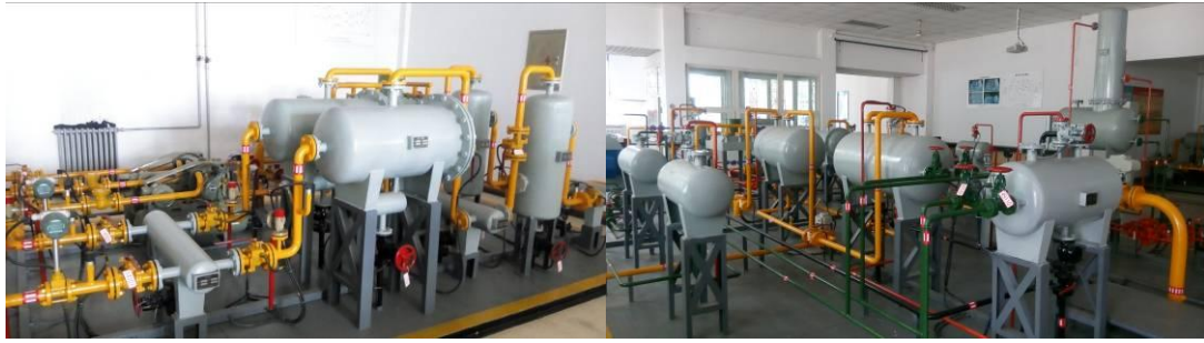
天然气长输实训室
