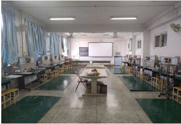
电工技术实训室
