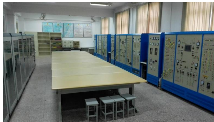
工厂供配电技术实训室
