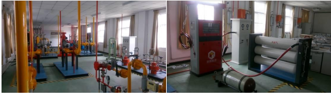
天然气储配实训室
